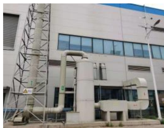
注液废气处理装置
