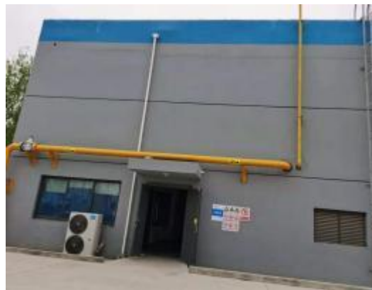
锅炉房天然气管道
