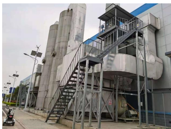
NMP回收装置
