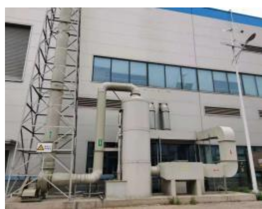
注液废气处理装置
