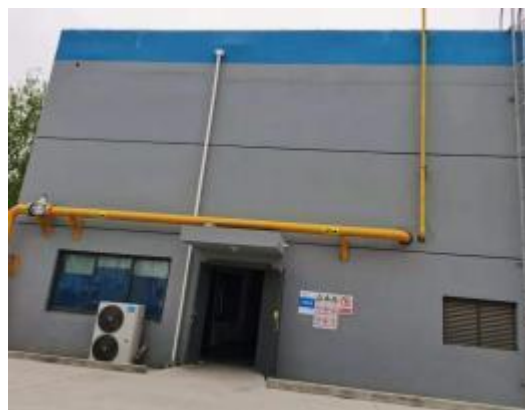
锅炉房天然气管道
